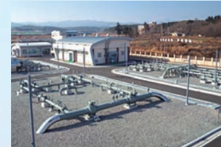
포항영덕 LNG 가스배관
